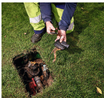
Analyse de l'arrosage automatique des pelouses. 400 sondes détectant l'humidité des sols devraient réduire de 30% la consommation d'eau.
